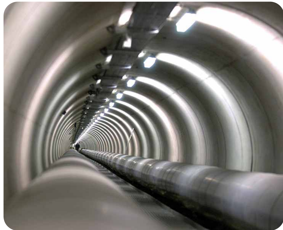
Bild : Fernwärmehöhle unter dem Rhein
